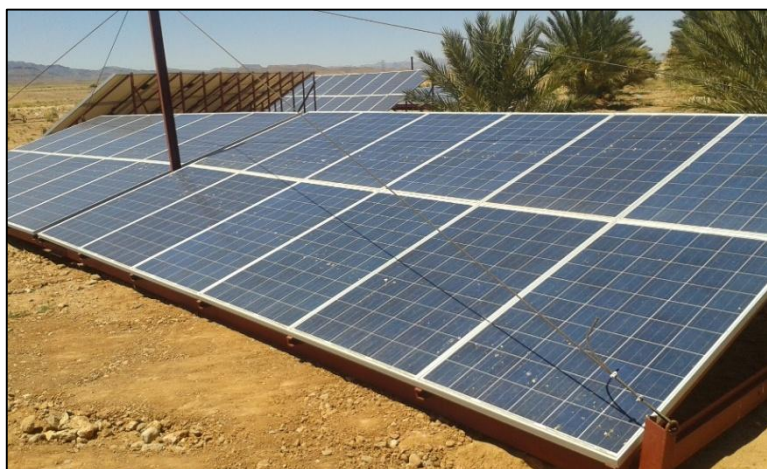
Figure 34. Panneaux solaire utilisés pour le pompage dans la zone de Tinjedad
