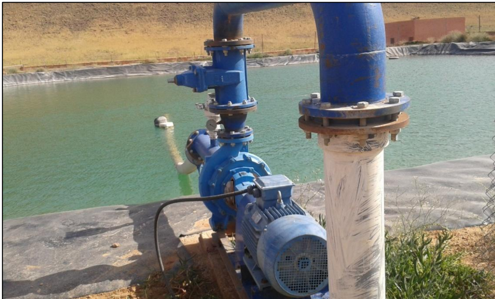
Figure 36. Pompe à axe horizontal installée dans un bassin de stockage pour le refoulement de l'eau d'irrigation
