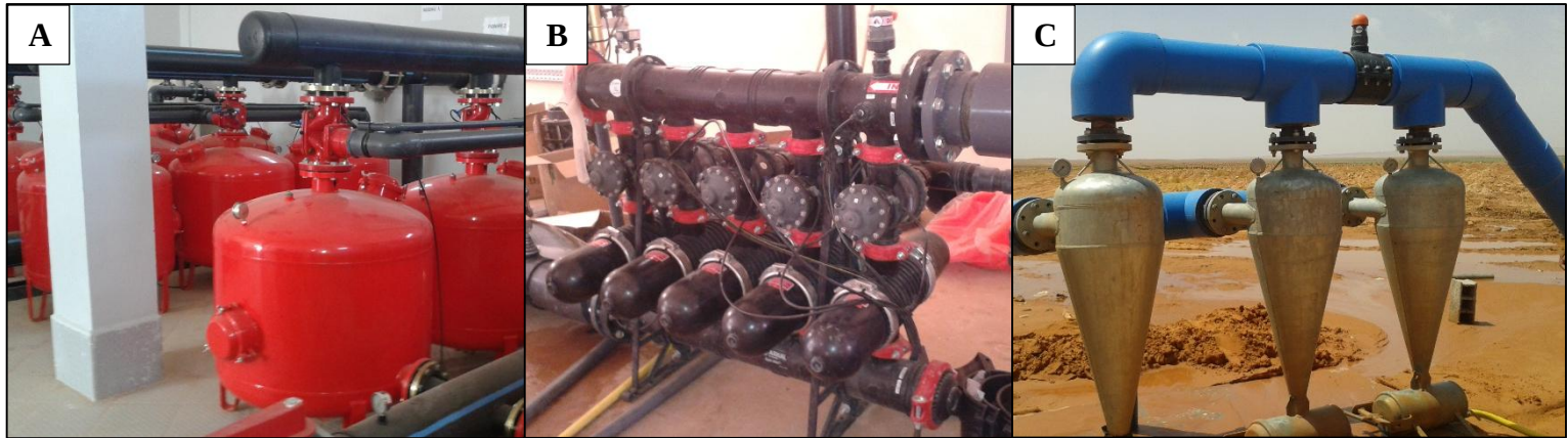
Figure 39. Principaux filtres installés, A : filtre à sable ; B : batterie de filtres à disques ; C : Hydrocyclones
